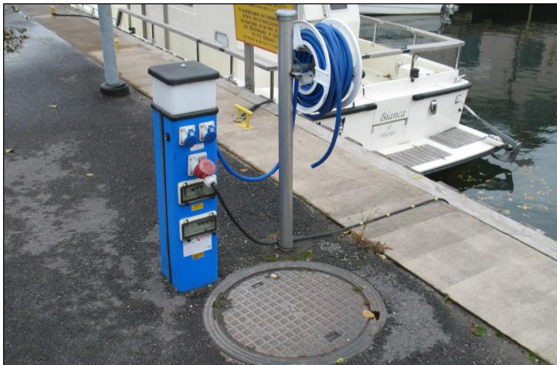
Kuva 20. Esimerkki yhdistetystä sähköpisteestä ja pollarivalaisimesta sekä vesipisteestä Hangonkylän venesatamasta.
